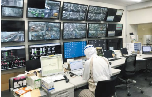
コントローラー室
